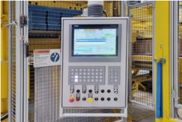
Steuerpanel für Pressanlage und Steinsetzautomat
