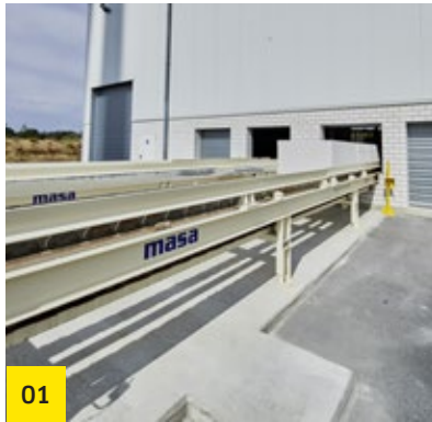
Aufgabestation Zuführung der vorgefertigten, vollen Planelemente.
